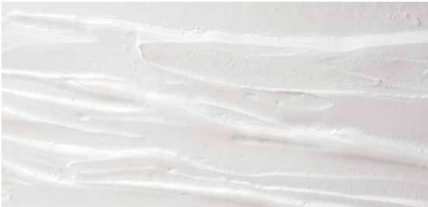
dettaglio detail détail
